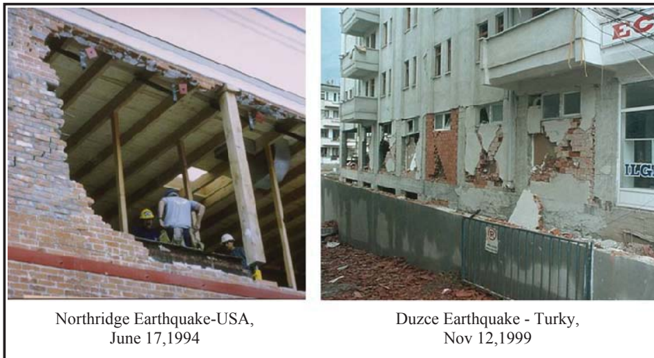
شکل ۱-۵- تخریب خارج از صفحه میانقاب‌های بنایی غیرمسلح در زلزله‌های نورتریج و دووز
