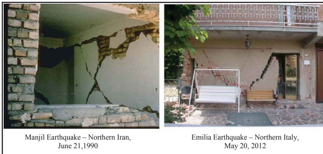
شکل ۹-۱- بروز ترک‌های قطری در دیوارهای بنایی غیرمسلح در زلزله‌های منجیل و امیلیا
